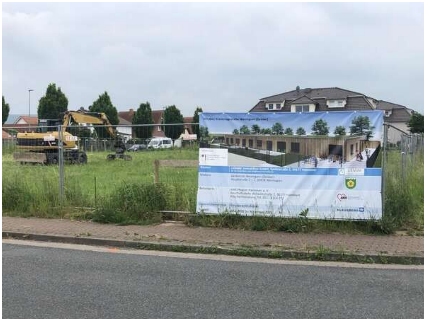
Der erste Bagger ist da: Hier soll es nächste Woche mit den Erdarbeiten für die neue Kita losgehen. Ursprünglich sollte diese bereits bis August 2019 betriebsbereit sein.foto: Jennifer Krebs,
